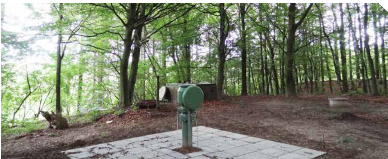
På billedet ses installationen på toppen af en af bakkerne, hvorunder tankene med brændstof er gravet ned.
