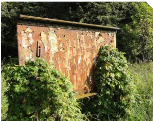
Anlæg i Panserkrat, der ikke mere bruges øvelsesmæssigt og bør fjernes.
