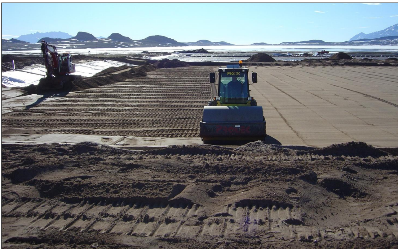
Figur 5.4: Faktaboks og foto fra anlæggelsen. Beskyttelseslaget tromles oven på den udlagte membran. T.v. fylder en gravko Sand 0-8 mm på plads ud mod kanten. Membranen kan anes ved siden af og bag ved gravkoen.
