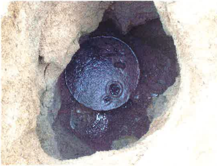
Billede 5 Taget under udgravning over tanke Olie er sort misfarvet gammel olie presset ud af tank ved dæksel over mandehuld.
